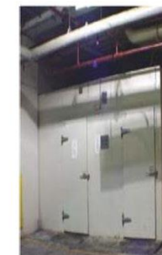
圖 12-43 垃圾冷藏設備
